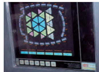
SISTEMA DI CONTROLLO A TOUCH SCREEN REALIZZATO DALLA IANIRO PER LA MOVIMENTAZIONE E LA MEMORIZZAZIONE DEI MOTORI PER I RIFLETTORI ACUSTICI
